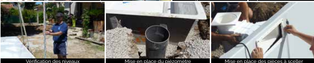
Vérification des niveaux
